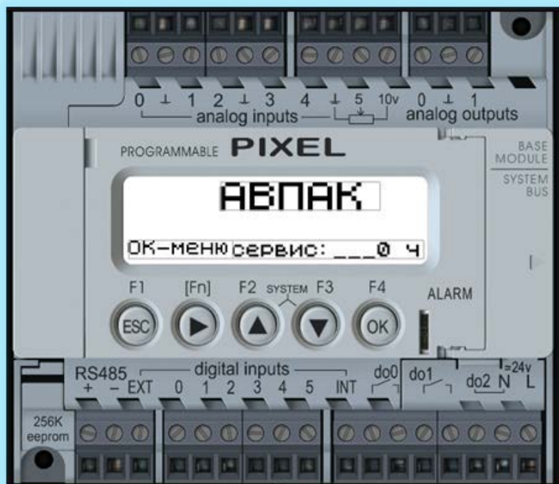
Рис. 7 Общий вид контроллера системы «ТАЙФУН АВ»
